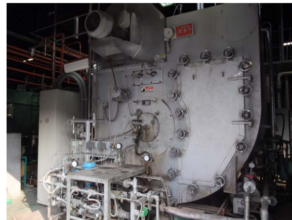
【コメ油投入ボイラ】
