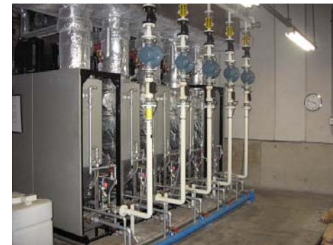
【ボイラー背面】
