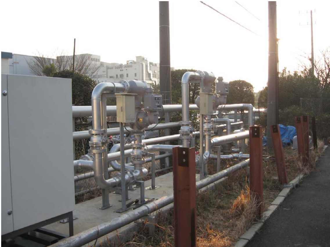
都市ガス供給設備
