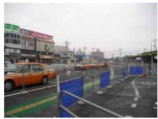
西鉄柳川駅周辺 (新駅舎の改設・東口の新設・それに伴う駅前再開発)
