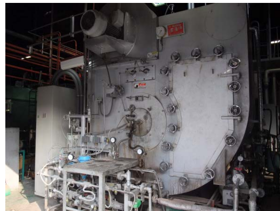
【コメ油投入ボイラ】
