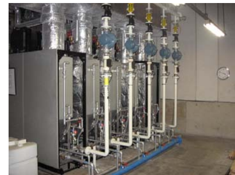
【ボイラー背面】
